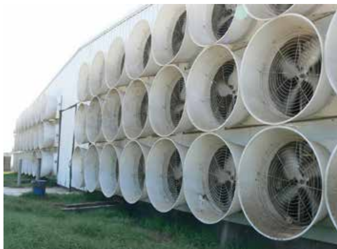
De stallen worden geventileerd door een batterij van grote ventilatoren, die samen met de sproeisystemen aan de andere zijde van de stallen de vochtigheidsgraad op peil houden.
